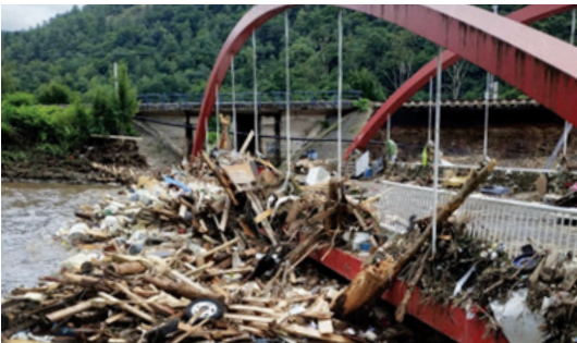
<그림 3> 교량 피해 사례 (벨기에(1) 교량)
