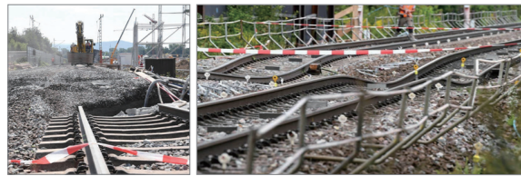
[그림 15] Rastatt 철도 TBM 터널 사고(독일 Rastatt, 2017)
