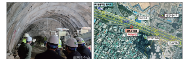
[그림 24] 부산 지하도로 NATM 터널 붕락사고 (2023, 부산)
