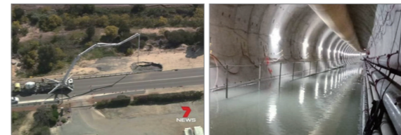
[그림 13] Forrestfield 공항철도 TBM 터널 붕락사고(호주 Perth, 2018)
