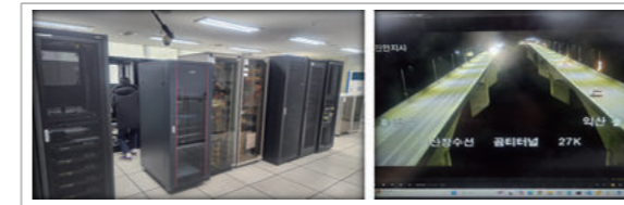
[그림 10] 분석서버 설치 및 CCTV 영상 조회 테스트
