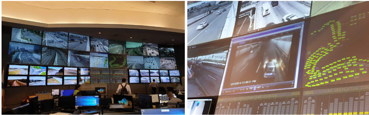
출처: Big Dig(Central Artery/Tunnel Project) 공개자료 <그림> 해외 지하도로 운영 사례 — 보스턴 Big Dig 교통관리센터 전경(좌)과 영상 유고감지·CCTV 관제 화면(우)
