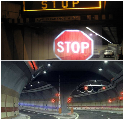
출처 : 초장대 K-지하고속도로 인프라 안전 및 효율 향상 기술 개발 연구개발 계획서, 2024.04. <그림> 위터스크린 방식을 이용한 진입차단시설 및 터널 내 진입차단시설 설치 사례
